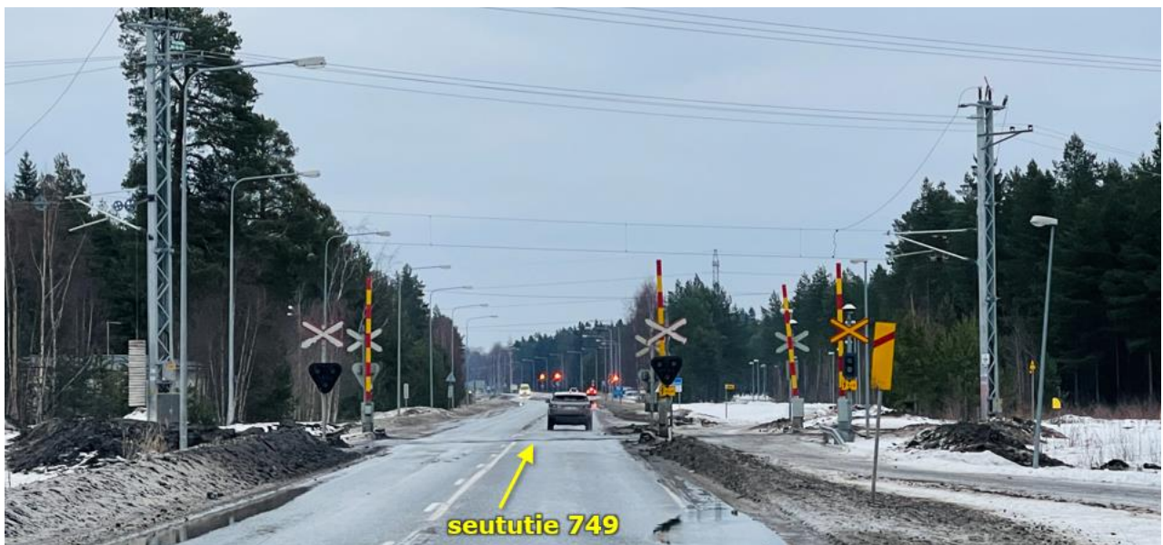
Kuva 6: Kokkolassa seututiellä 749 Varikon tasoristeyksessä on ajojohtimien nostolaitteisto.
