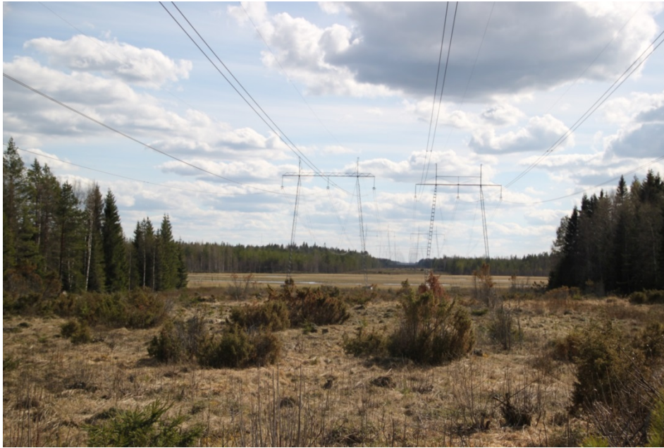
Kuva 38. Fingridin 400 kV voimajohdot Iso-Salmijärven kohdalla.
