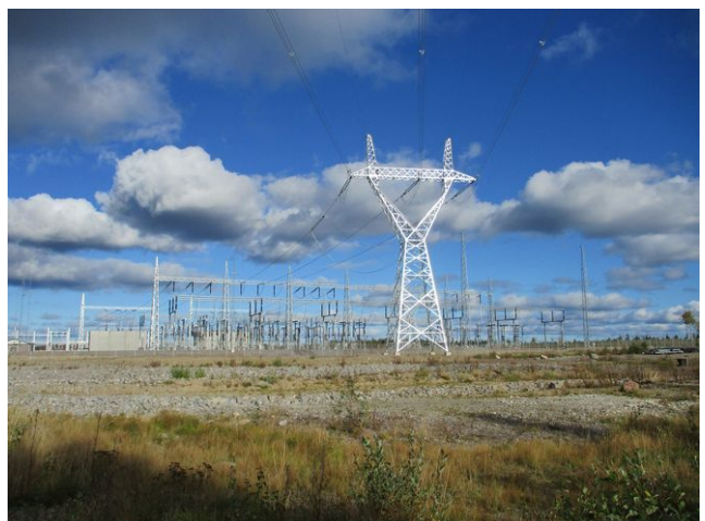
9. Valkeuden sähköasema, koilliseen .
