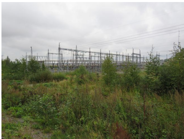
21. Ahonkylän muuntoasema, koilliseen.
