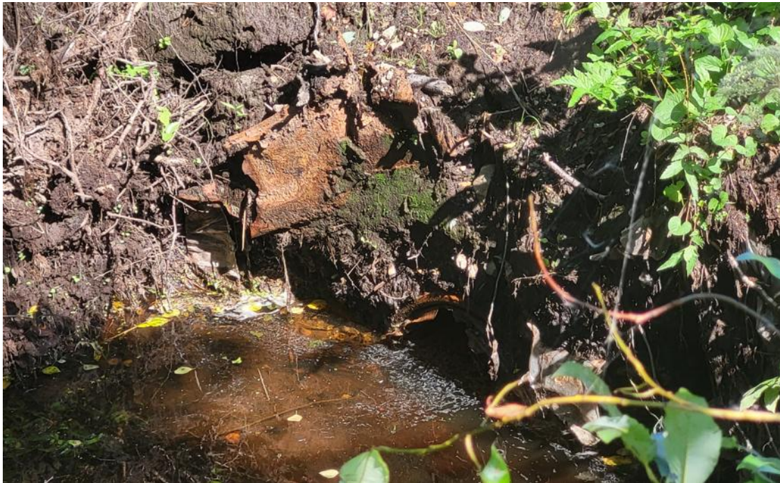
Kuva 16 Huonokuntoinen rumpu kuvattu pisteessä 1A.
