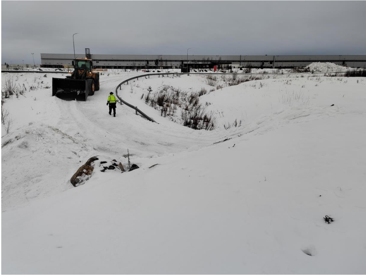
Kuva 1. Isolammintien puoleinen läjityksen reunaluiska oli helmikuussa jyrkkä ja jäinen. Kauhakuormaajalla tutkittiin luis- kaa 13.04.2024. Luiskaa jouduttiin loiventamaan mm. murskeella ja soralla.
