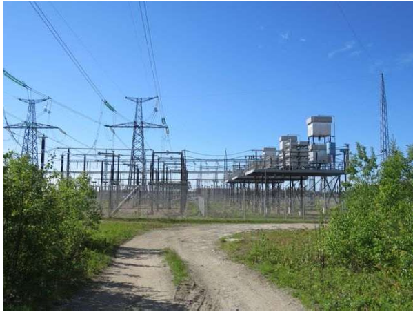
Kuva 45. Keminmaan sähköasema etelään.
