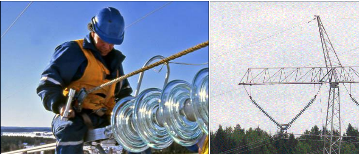
Kuva 88. Voimajohtopylvään eristimiä, joissa koronapurkauksia voi esiintyä.
