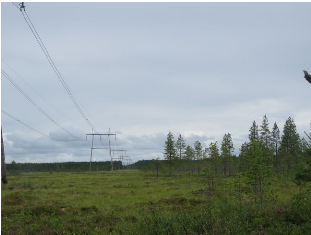
Kuva 60. Ilmajohdon liittymiskohta Saukkosuolla.
