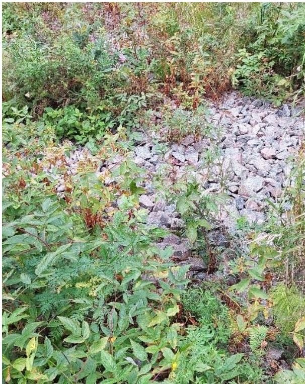
Kuva 30. Kartoilta pois jääneen tien pinnalle tuotua suurirakeista sepeliä. Kuvattu pohjoiseen. Kuva: Oskari Sairanen, Maanala Oy.
