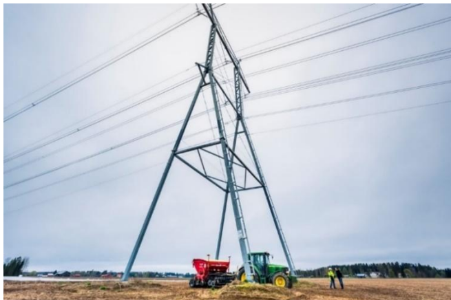
Kuva 16. Peltopylväs (Fingrid Oyj).
