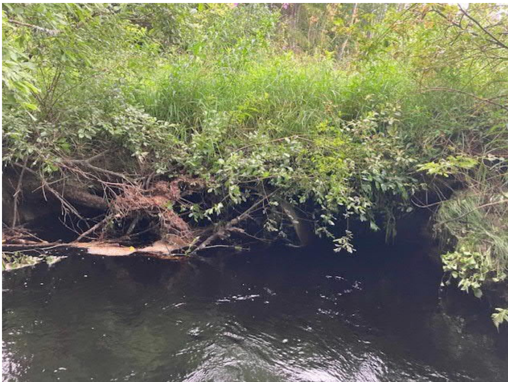
Poikkijoki, pellonreuna, kasvillisuuden osin peittämä metallinen siltarumpu, ei nousuestettä
