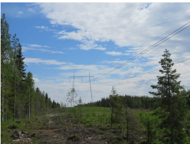
Kuva 7. Voimalinja kuvattuna Leväjängästä länteen.
