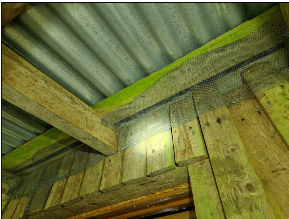
Kuva 10. Metsästyskopin katonrajan verkkosuojaus.
