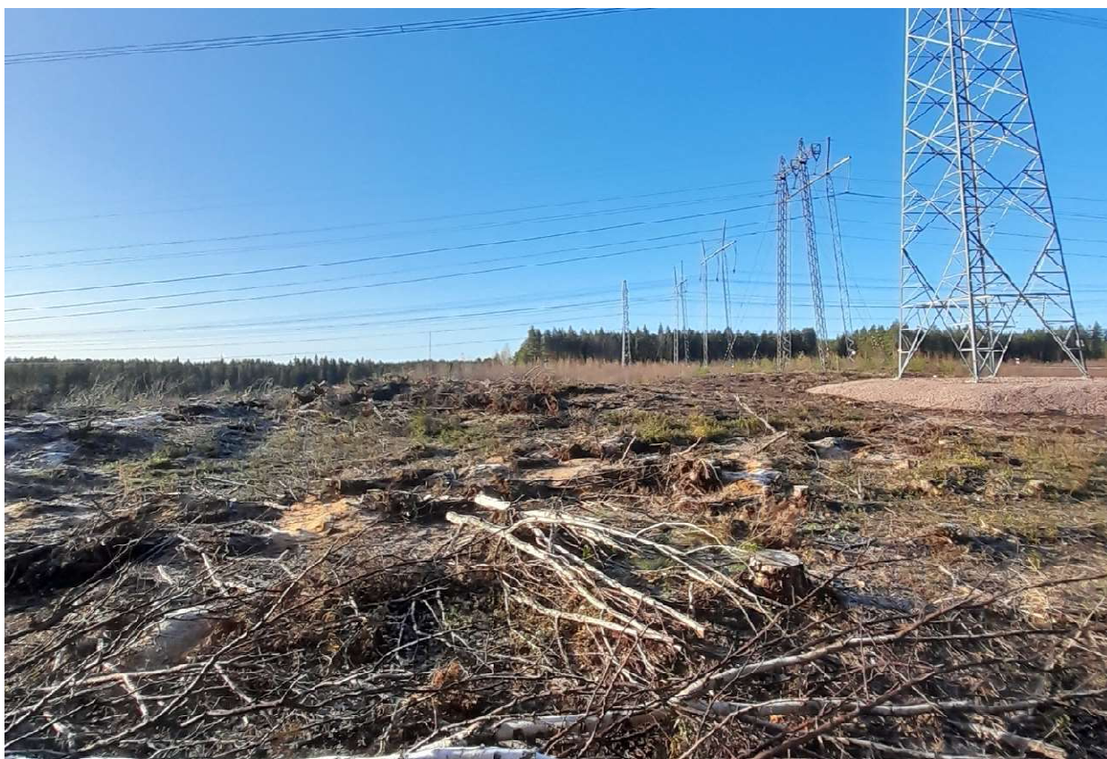
Kuva 23. Pyhäkoski 1:n vaurioitunutta kivitautista kohdetta kuvattuna alueen itäpäästä. Kuva: Taneli Leinonen.
