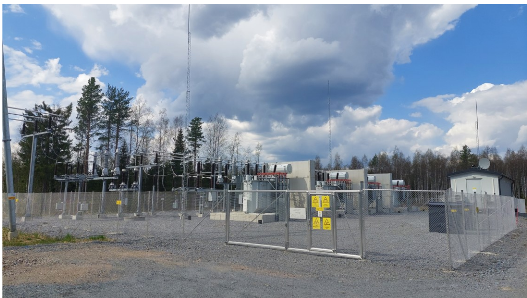
Kuva 13. Esimerkki tuulivoimapuiston sähköasemasta (Välkankaan tuulipuisto, Haapajärvi).
