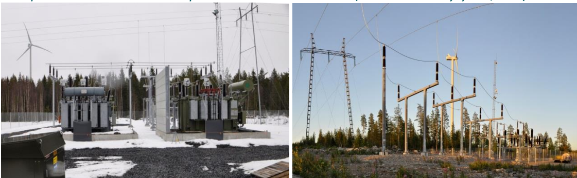
Kuvapari 4-17. Esimerkkikuvia tuulivoimapuiston 110/20 kV sähköasemasta. (Kuvat: Leila Väyrynen, FCG).
