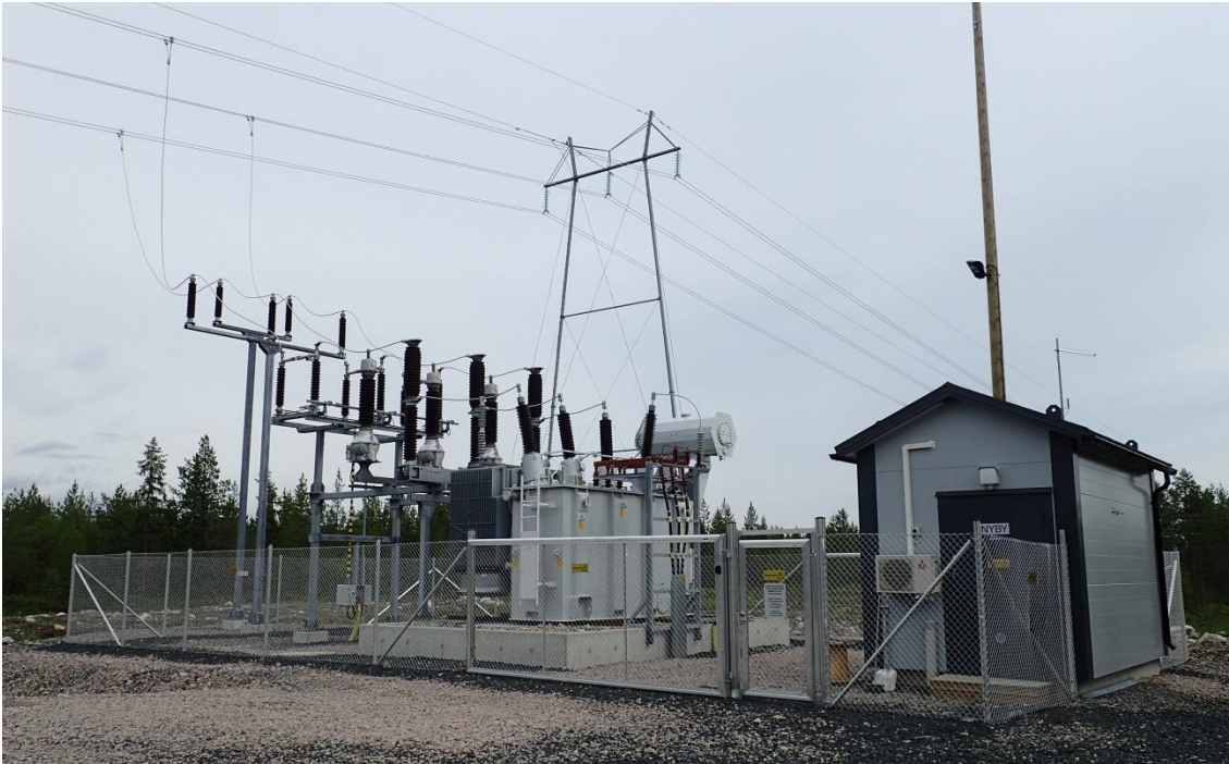
Kuva 4-9. Esimerkki tuulivoimapuiston sähköasemasta (kuva: FCG).
