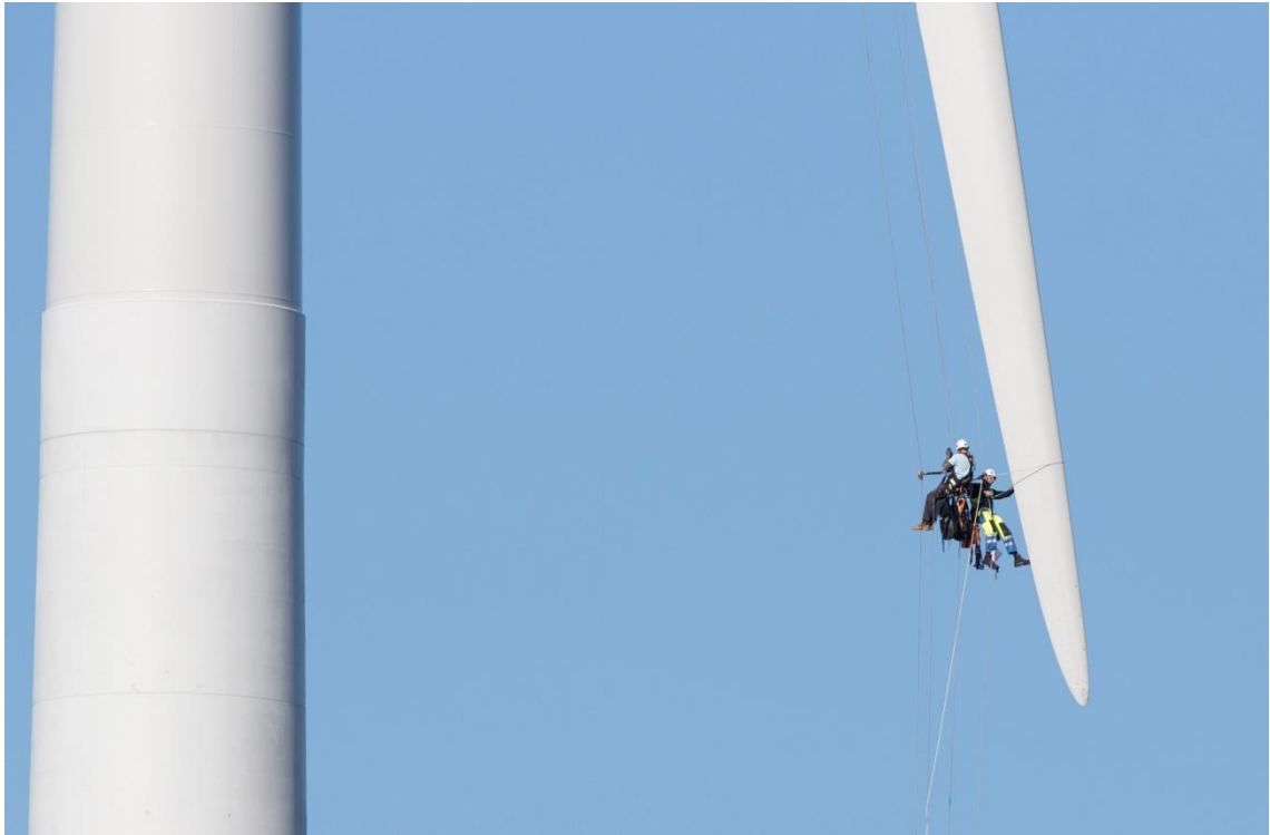
Kuva 4-20. Tuulivoimalan huoltotoimenpiteitä. (Kuva: FCG).
