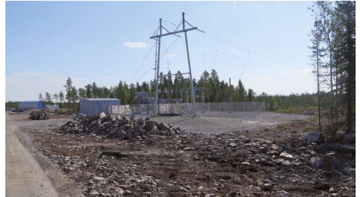
Kuva 5. Tuulipuiston sähköasema. Kuva Mäkikankaan tuulipuiston sähköasemasta Pyhäjoelta © wpd Finland Oy.
