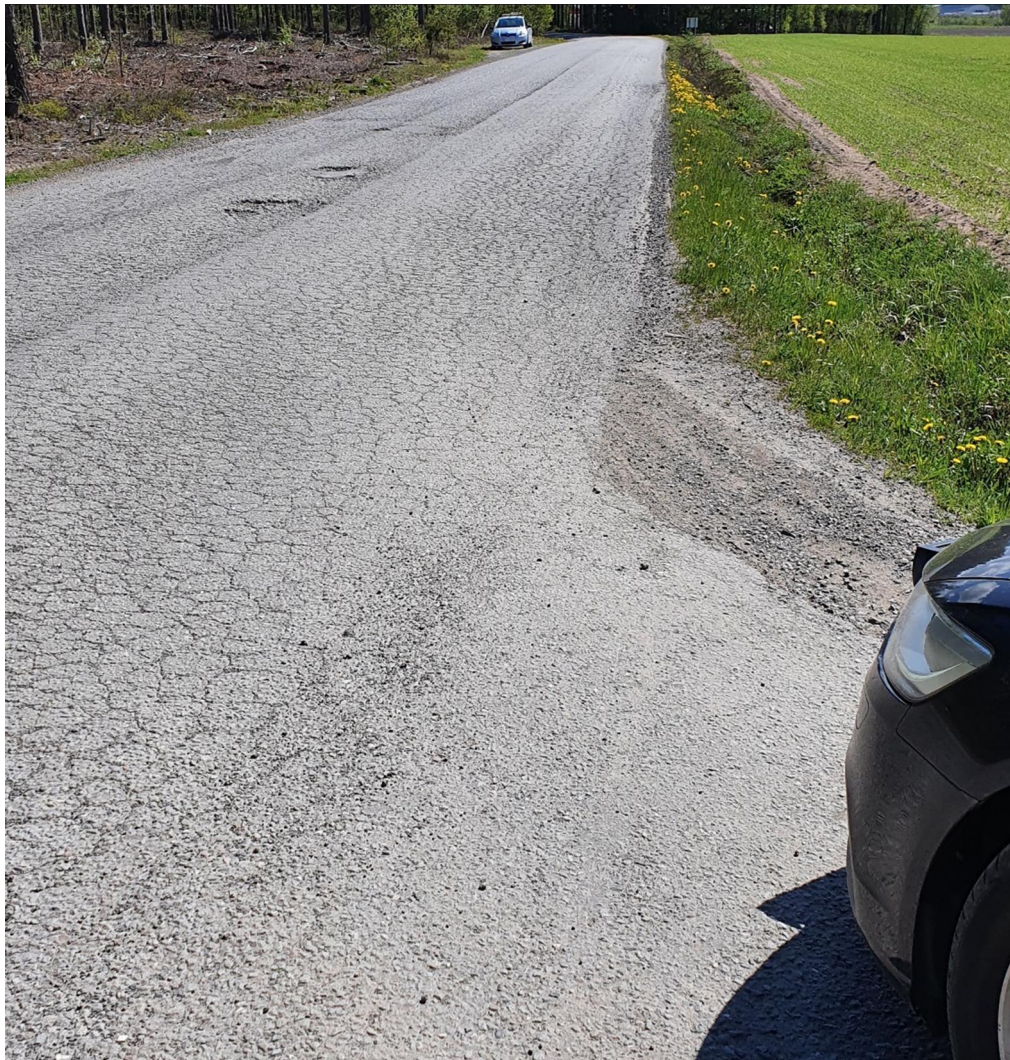
Kuva 6. Metsäkulmantie Oikotien päästä kuvattuna. Päälysteen pinnassa verkkohalkeamaa.
