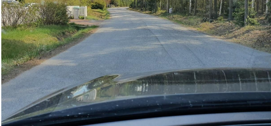
Kuva 7. Oikotie kuvattuna Sievarin kaupunginosan suuntaan. Päälysteen pinnassa verkkohalkeamaa.
