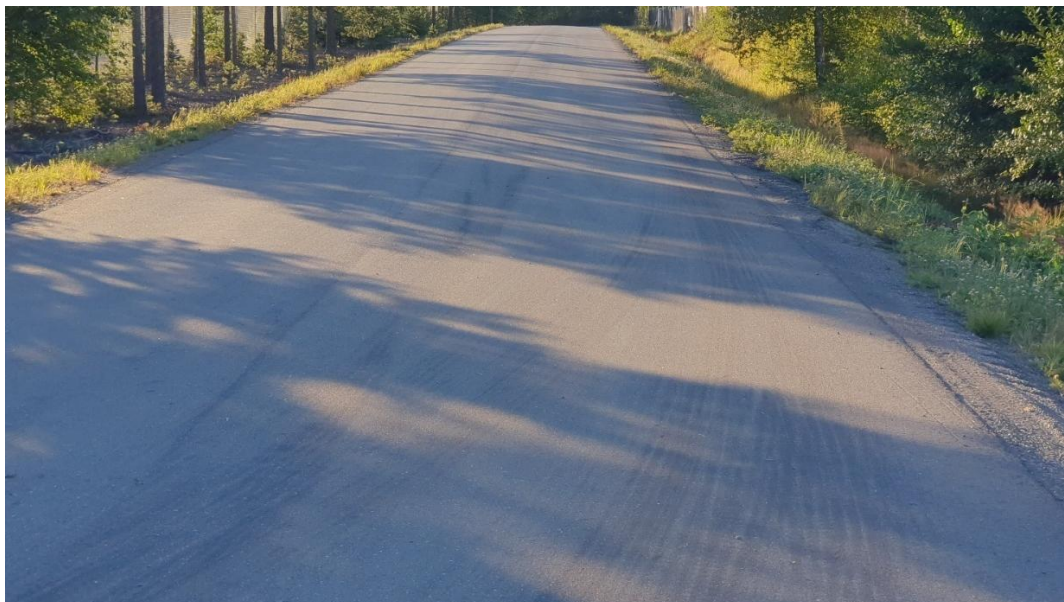
Kuva 14. Ratalankatu. Vasemmalla Boliden Harjavalta Oy:n kaatopaikka. Päälystetty hiljattain.
