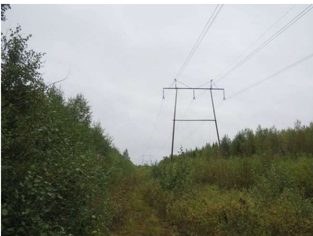
Kuva 47. Yhtymäkohta VE2 - Taivalkosken-Petäjääskosken 220 KV linjan käytävälle.
