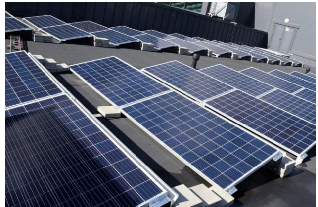
Aurinkopaneelit kauppakeskuksen katolla (Kuva: Yle)
