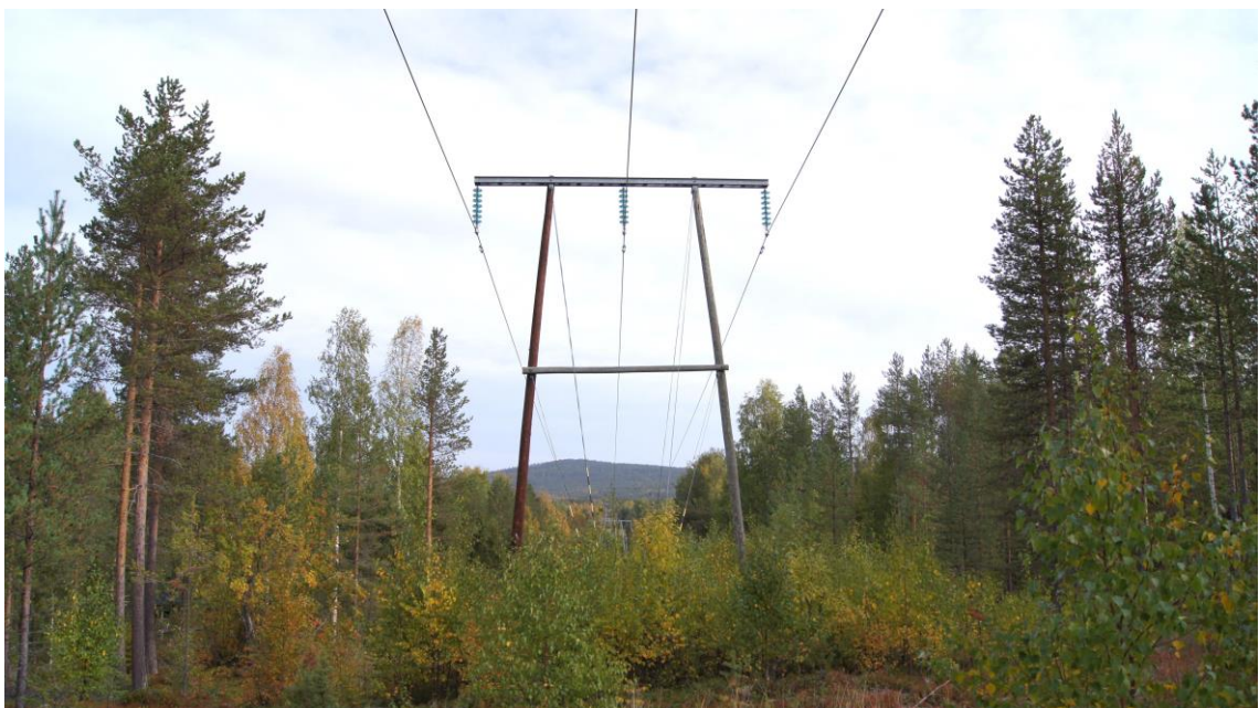
Kuva 4.11. Olemassa oleva Tornionlaakson Sähkön 110 kV voimajohto. (Kuva Riikka Arffman, wpd)
