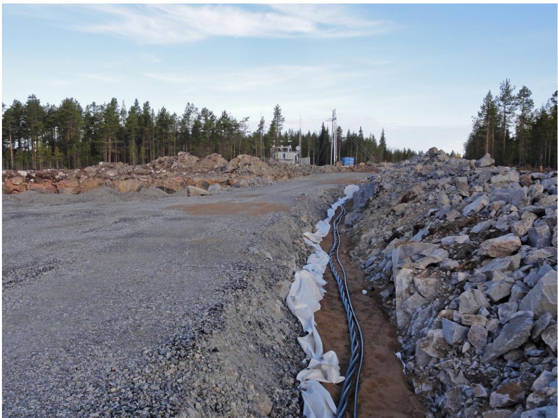
Kuva 4.8. Esimerkki tuulivoimapuiston rakennus- ja huoltotien rakentamisesta. Teitä käytetään muun muassa betonin, soran ja voimaloiden komponenttien kuljetuksiin sekä tuulivoimapuiston käyttövaiheessa huoltoajoihin. Maakaapeli sijoitetaan ojakaivantoa tien reuna-alueelle (Kuva: Ville Suorsa / FCG).
