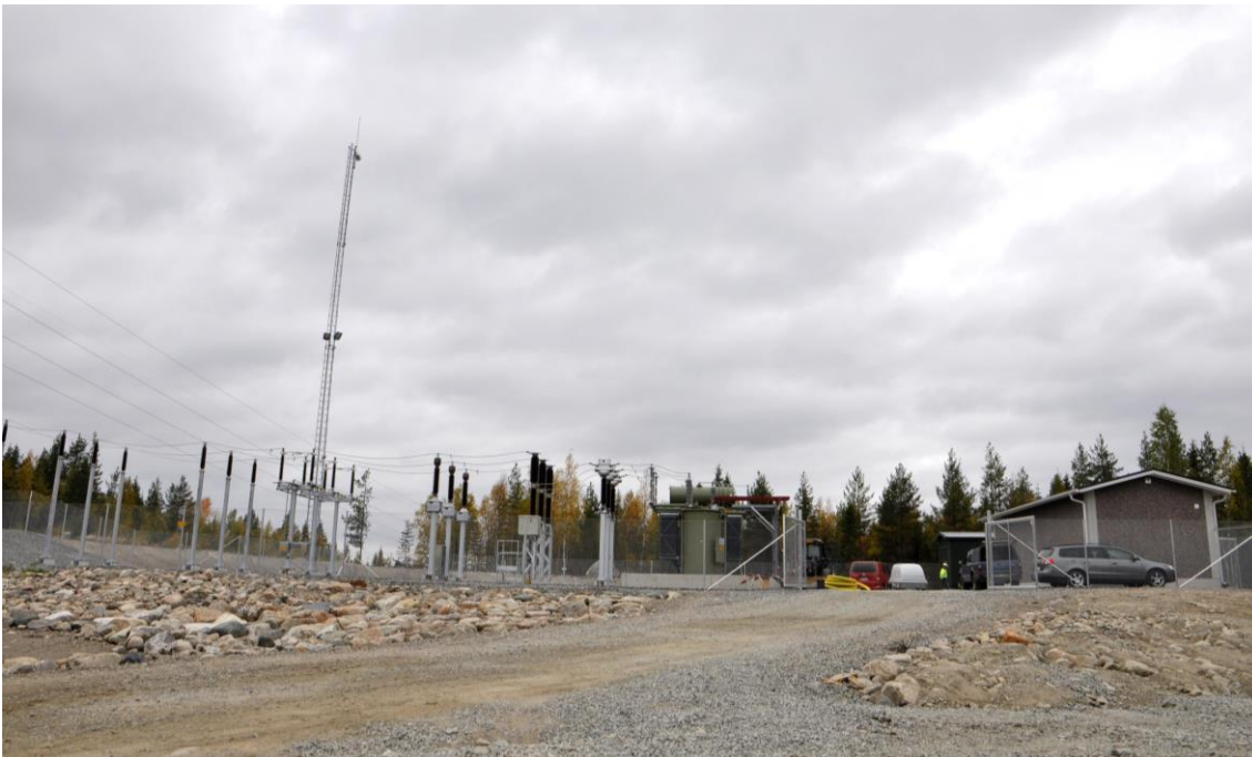
Kuva 4.9. Esimerkkikuva tuulivoimapuiston 110/20 kV sähköasemasta. (Kuva: Leila Väyrynen/FCG).
