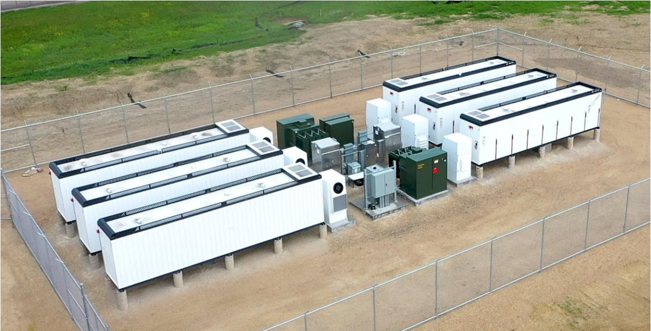
Bild 3.7. Ett exempel på Alliant Energys 5 MWh batterilagringssystem (Alliant Energy Corp.).
