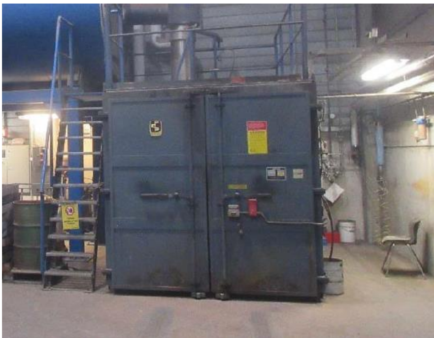
Kuva 1. Kuusakoski Oy:n Heinolan tehtaiden pyrolyysiuuni.
