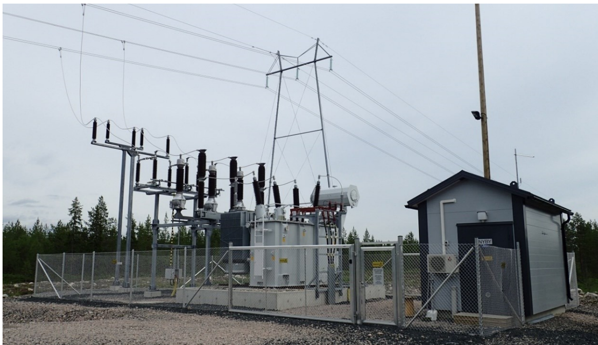
Bild 5.7 Exempel på elstation (FCG).
