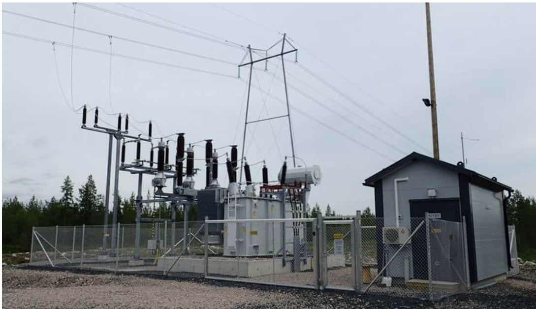
Kuva 5.8 Esimerkki tuulivoimahankealueen sähköasemasta (FCG Finnish Consulting Group Oy).
