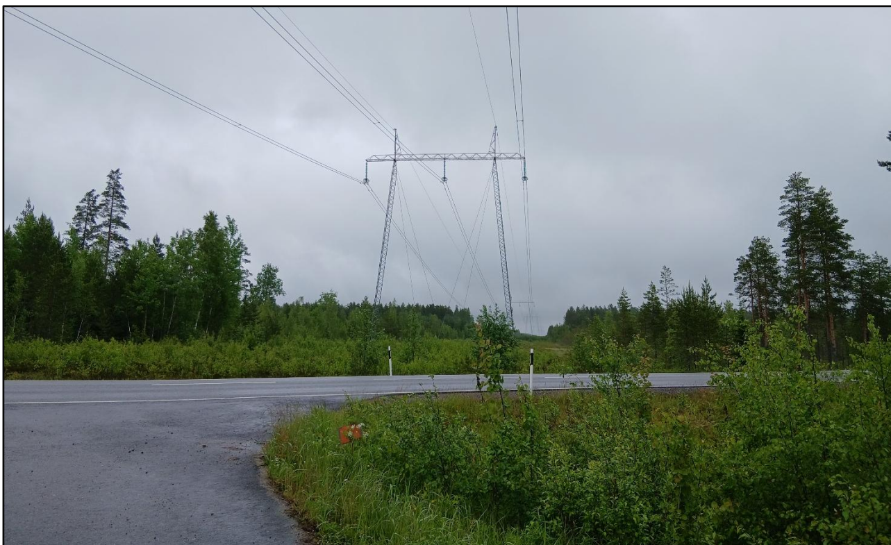
Kuva 23. Seinäjoki-Ulvila-johto ylittää Tokerotien Kukkookallion hankealueen eteläpuolella (E: 265 727, N: 6 935 458 (ETRS-TM35FIN)) (A-insinöörit Suunnittelu Oy).
