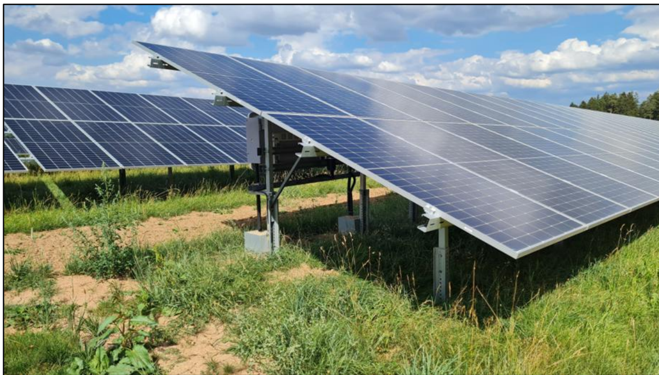
Kuva 17. Esimerkkikuva kiinteästä etelään suunnatusta aurinkopaneelijärjestelmästä. (Fortum Oy)
