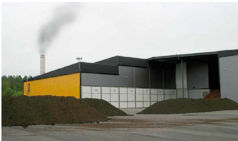
Kuva 5-22 Kompostointilaitoksen biosuodatin, jonka kapasiteetti riittää myös hankekokonaisuudessa esitettyjen laitosten hajukaasujen käsittelyyn
