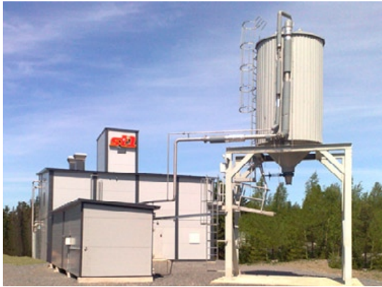
Kuva 4-6 Bioetanolin valmistuslaitos (kuva: www.st1.fi )
