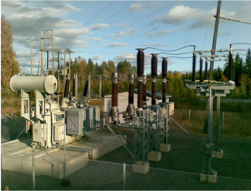
Kuva 2-7. Esimerkki tuulipuiston 20/110 kV sähköasemasta.
