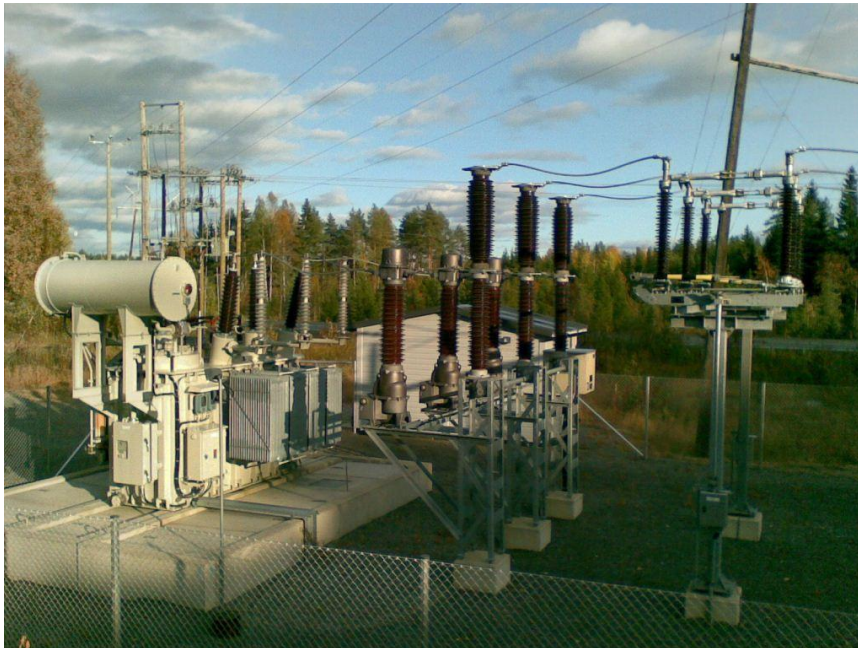
Kuva 3-6 Esimerkki tuulipuiston 20/110 kV sähköasemasta (kuva: Pöyry Finland Oy).
