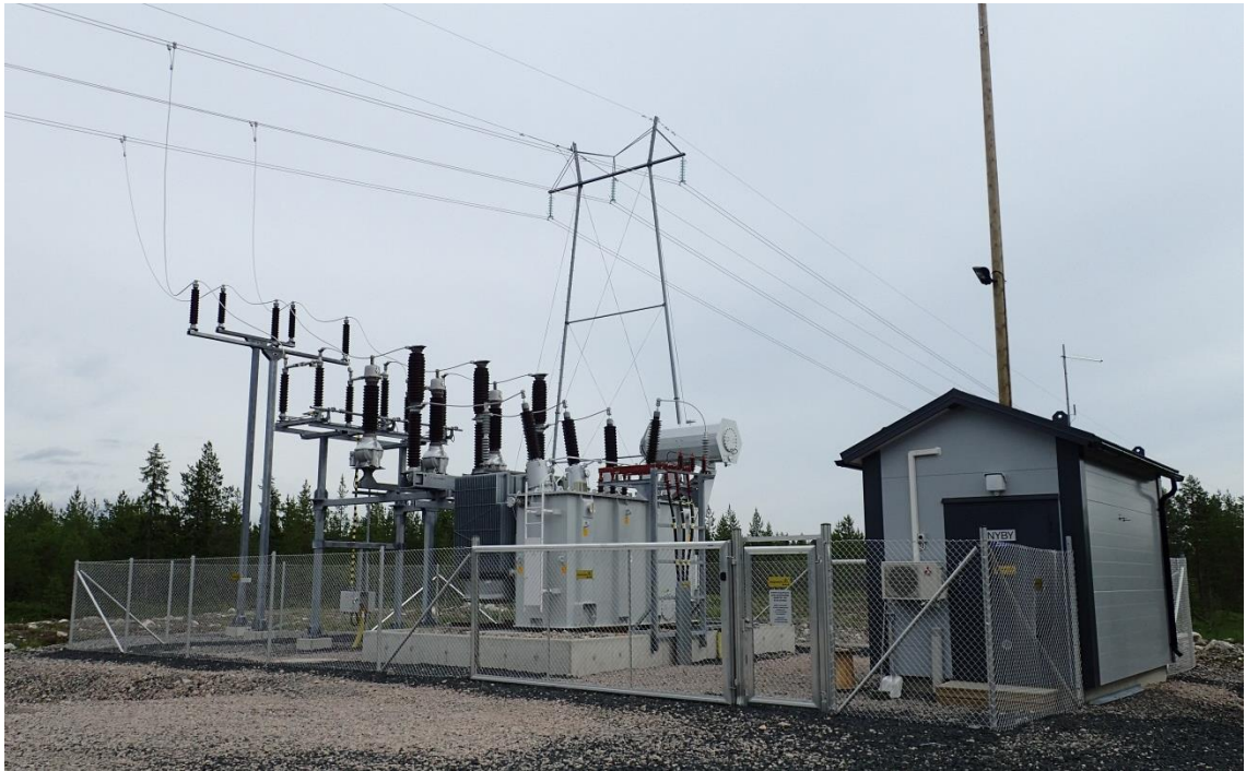
Kuva 5.7. Esimerkki tuulivoimapuiston sähköasemasta (kuva Minna Takalo/FCG).
