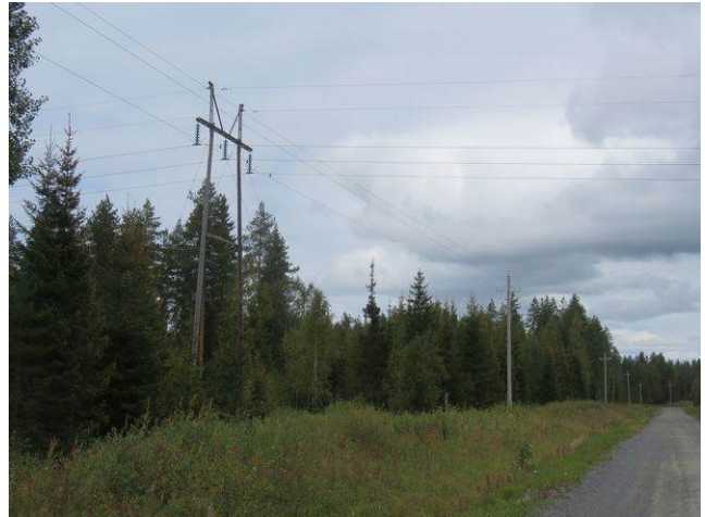
Kuva 36. Liittymiskohta 110 kV linjaan..
