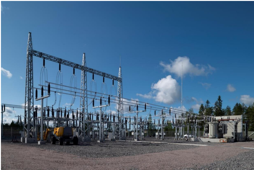
Kuva 3-2. Esimerkki tuulivoimahankeeseen sähköasemasta. © Ilmatar Energy Oy.
