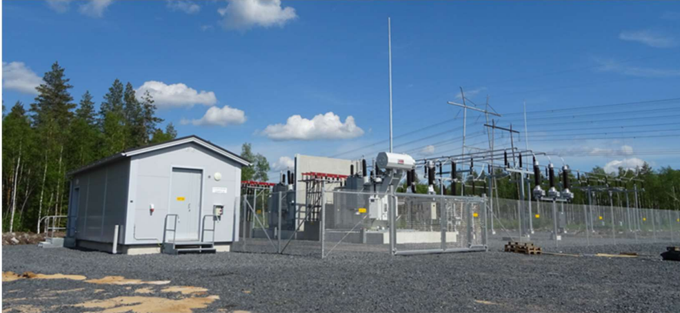
Kuva 10. Esimerkki tuulivoimapaiston sähköasemasta (Oltava, Pyhäjoki).
