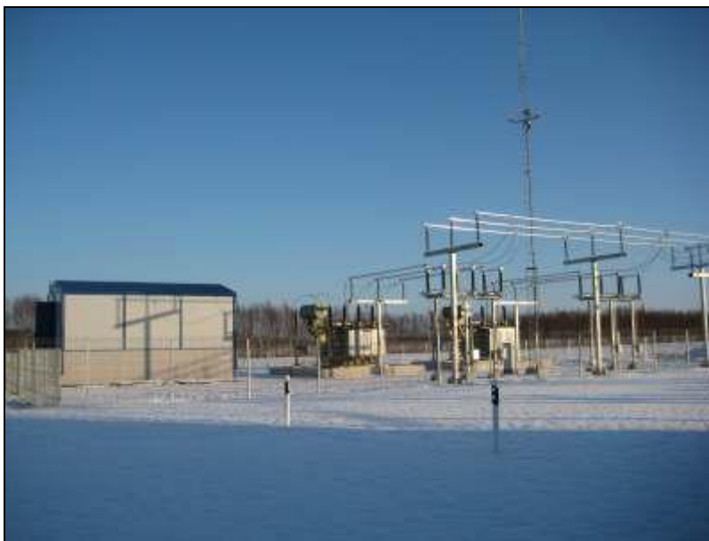
Kuva 3-11. Sähköasema (Kuva: Eltel Networks Oy).
