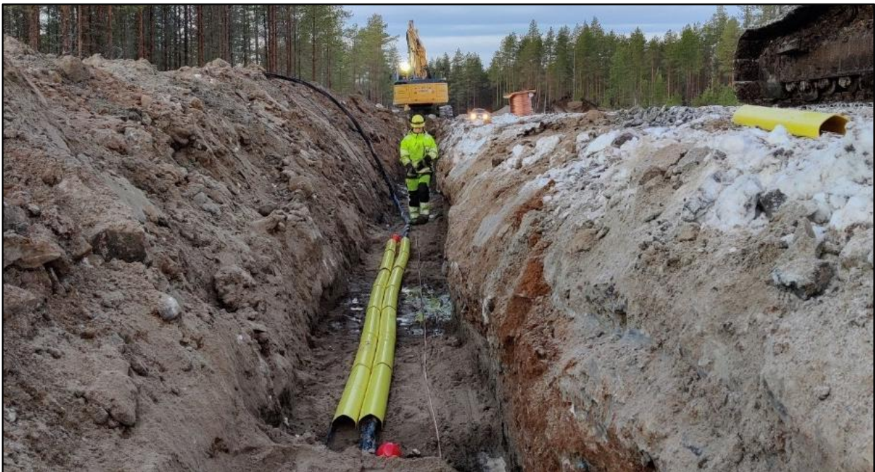
Kuva 28. Esimerkkikuva tuulivoimalan kaapeliasennuksista (Taaleri Energia Oy).
