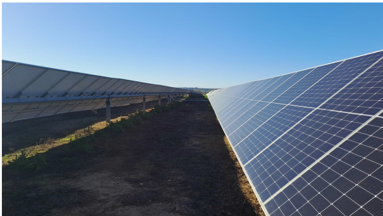
Kuva 40. Aurinkopaneeleja. (Taaleri Energia)
