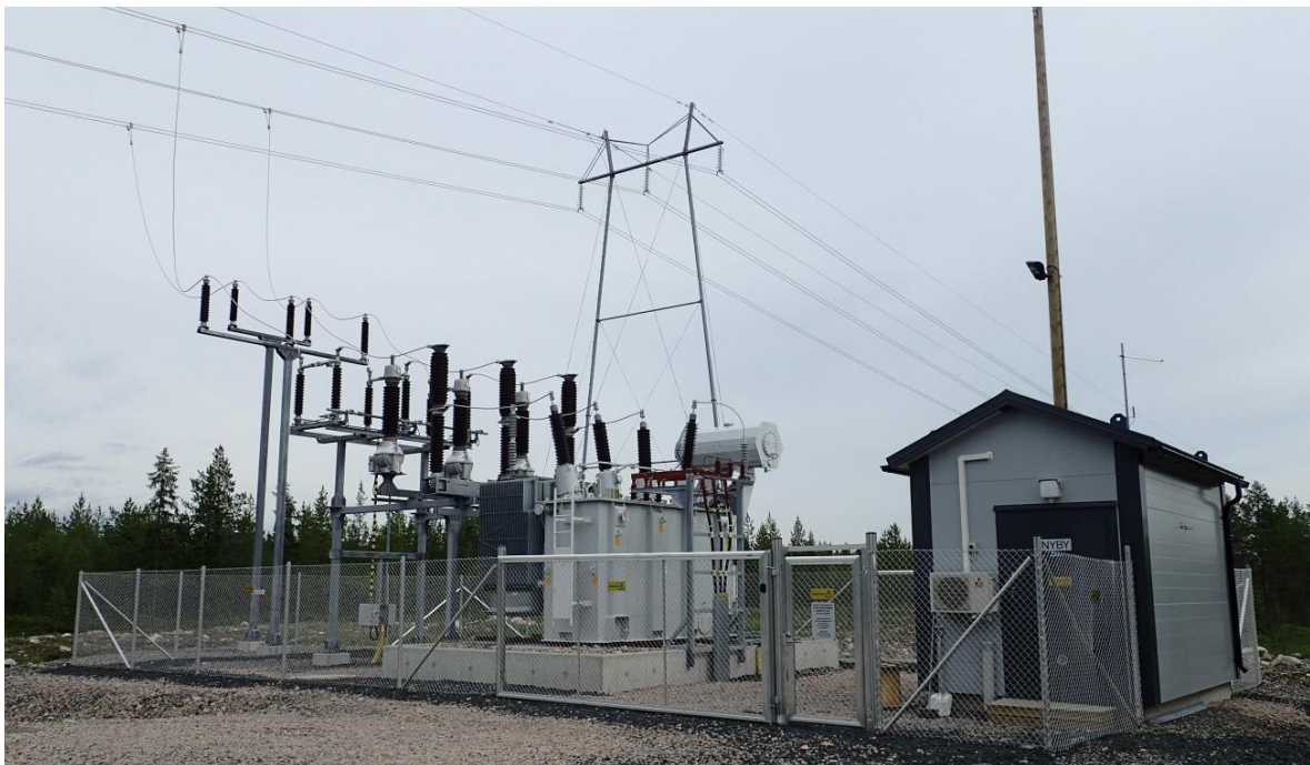
Kuva 5-7 Esimerkki tuulivoimapuiston sähköasemasta (FCG Rakennettu Ympäristö Oy).
