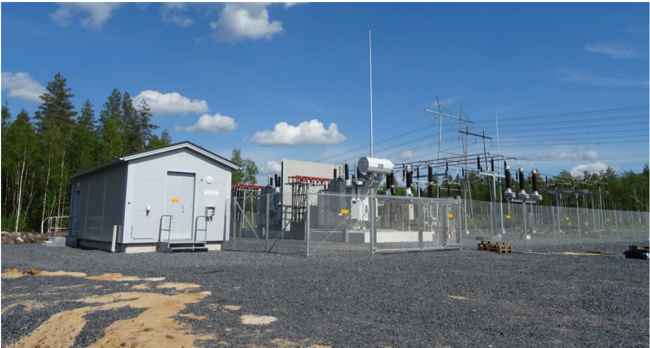
Kuva 19. Esimerkki tuulivoimapuiston sähköasemasta (Oltava, Pyhäjoki) (Kuva: Sweco Finland Oy).
