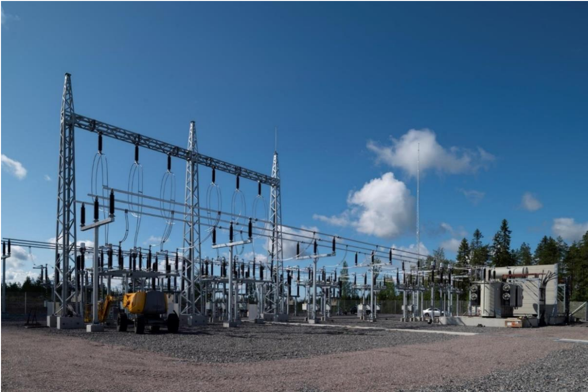
Kuva 3-2. Esimerkki tuulivoimahankkeen sähköasemasta. © Ilmatar Energy Oy.
