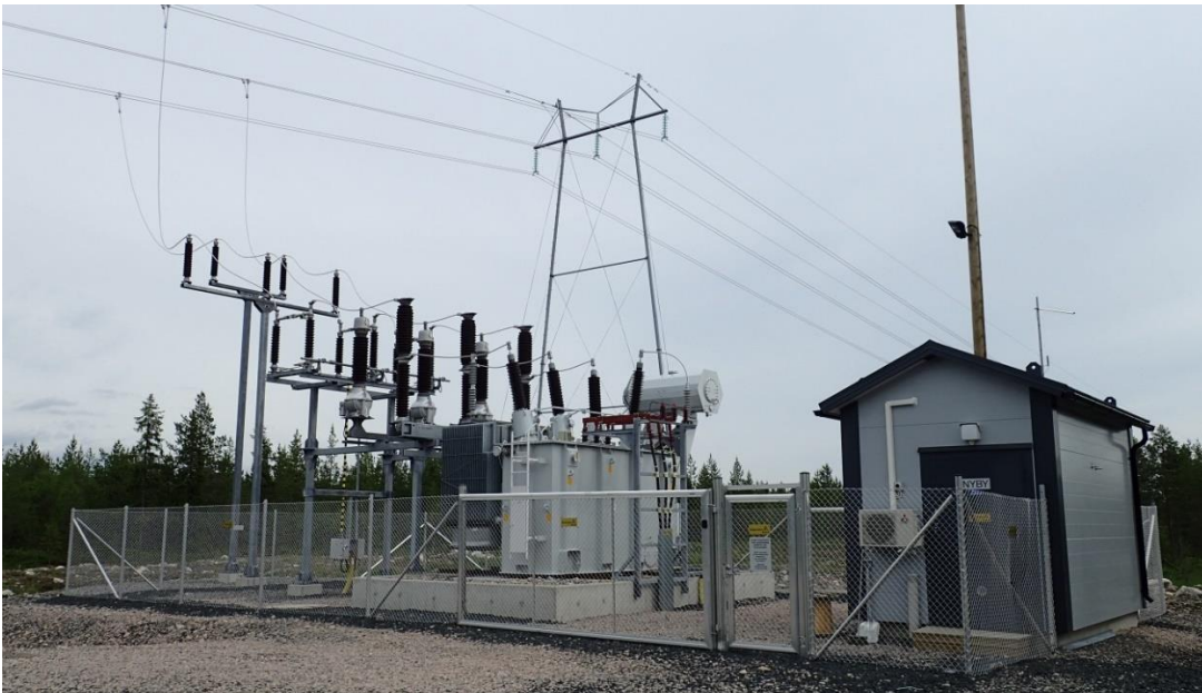
Kuva 5.8. Esimerkki tuulivoimapuiston sähköasemasta (Kuva: Minna Takalo/FCG).
