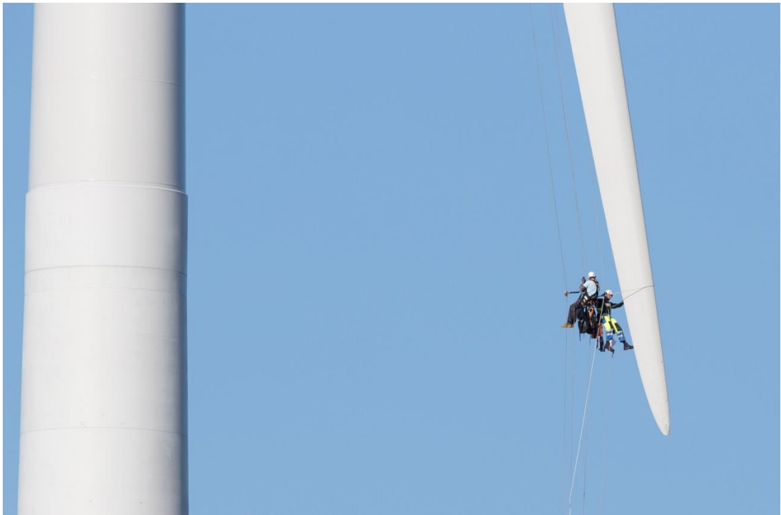
Kuva 4-18. Tuulivoimalan huoltotoimenpiteitä. (Kuva: FCG).
