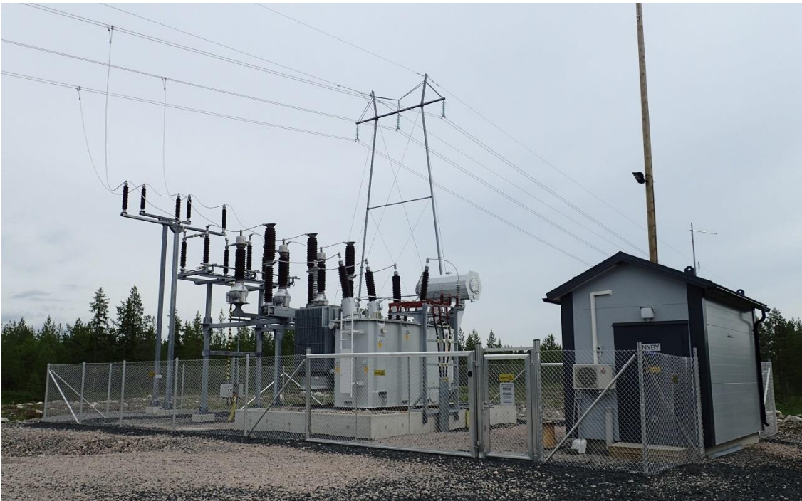
Kuva 4-8. Esimerkki tuulivoimapuiston sähköasemasta (kuva: FCG).
