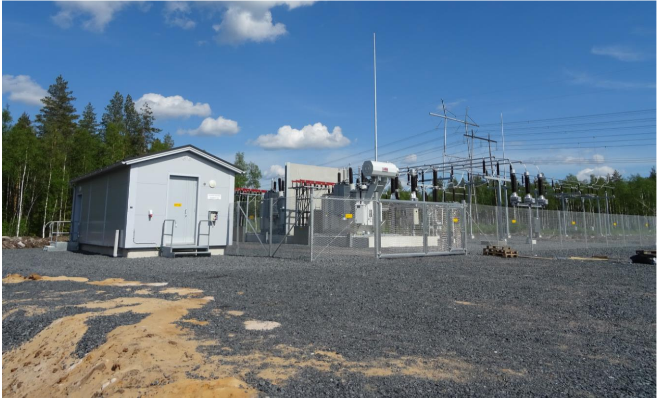
Kuva 20. Esimerkki tuulivoimapuiston sähköasemasta (Oltava, Pyhäjoki). (Kuva: Sweco)
