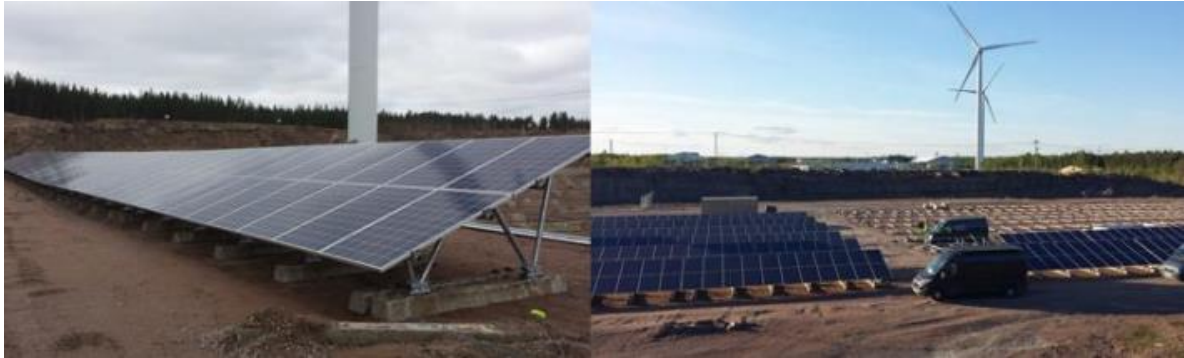
Kuva 5-10 Esimerkki aurinkopaneeleista (Suomen Voima Oy, Haminan Mäkelänkankaan aurinkovoimalat).
