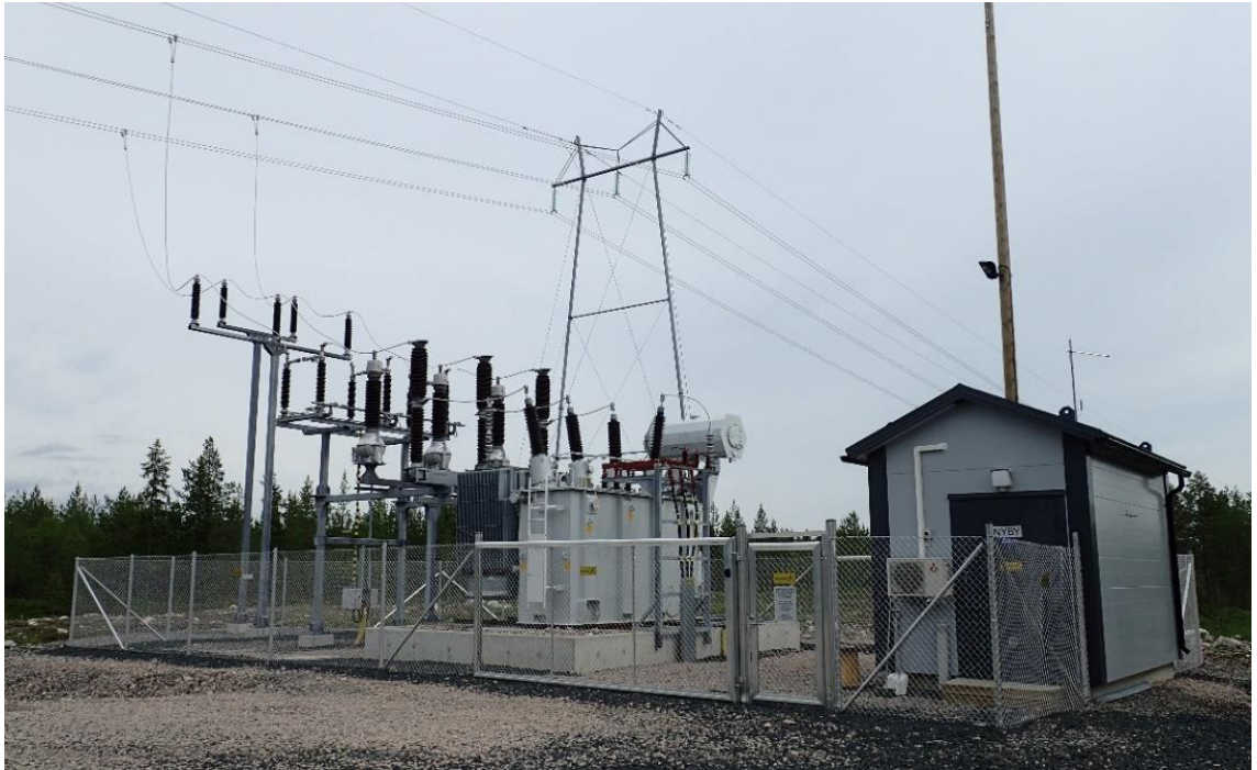
Kuva 2-13. Esimerkki tuulivoimapuiston sähköasemasta.
