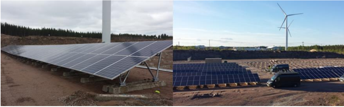
Kuva 4.12. Esimerkki aurinkopaneeleista (Suomen Voima Oy, Mäkelänkankaan aurinkovoimalat, Hamina).
