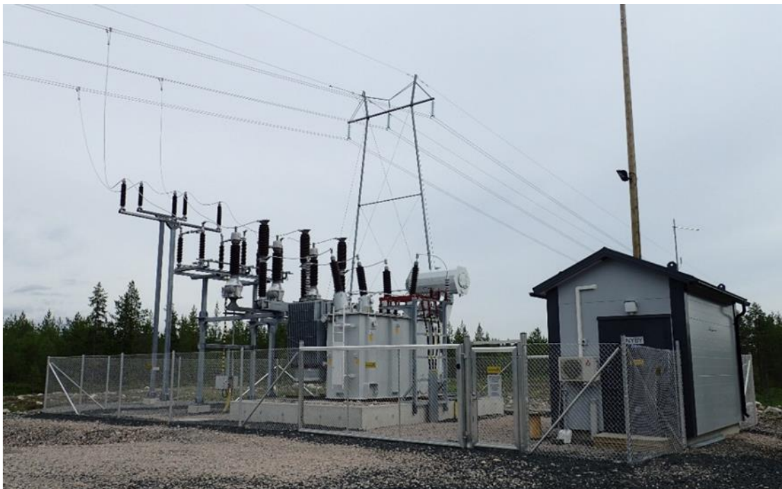
Kuva 4.8. Esimerkki tuulivoimapuiston sähköasemasta (Kuva: FCG).
