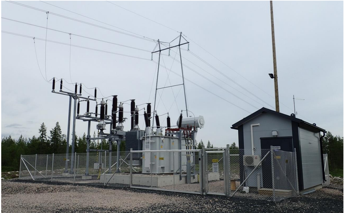
Kuva 17. Esimerkki tuulivoimapuiston sähköasemasta (Minna Takalo, FCG).
