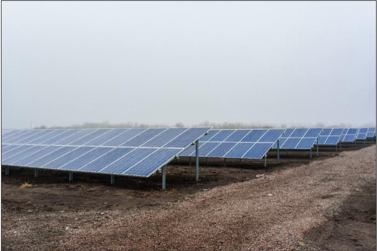
Kuva 12. Asennettuja aurinkopaneelitelineitä (kuva Neova Oy).
