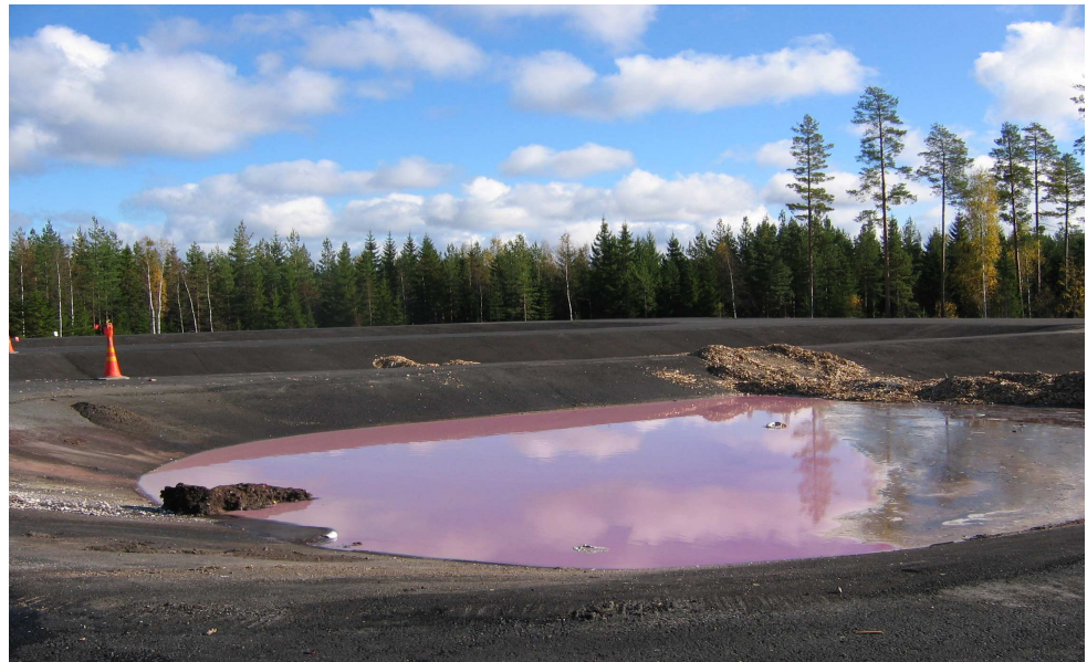
Kuva 10.10 Nestemäisten jätteiden käsittelyallas
